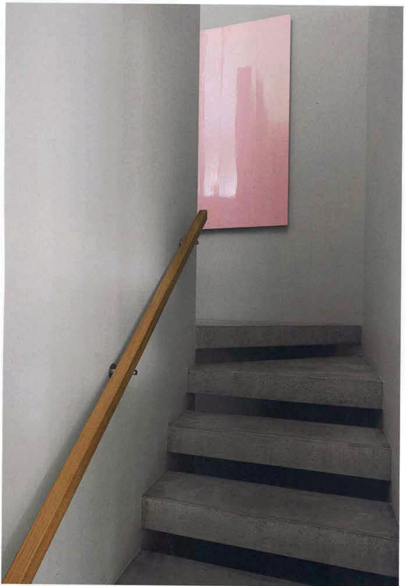
Die Treppenstufen mit ihrem Terrazzocharakter sind vorgefertigte Betonelemente. Passend dazu der kühl graue Wandanstrich.
